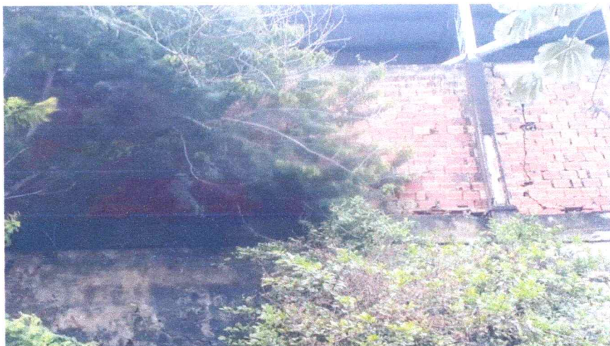
Figura 1 - Fissuras em paredes
