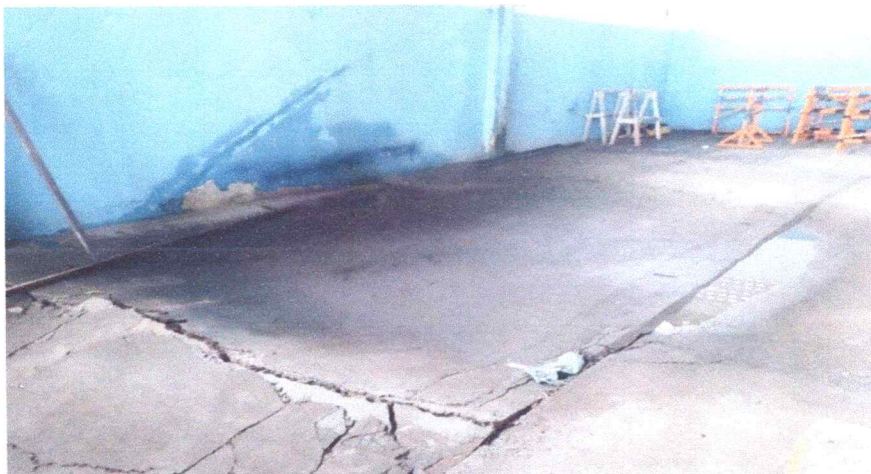
Figura 2 - Recalque de piso
