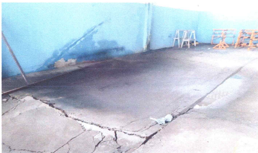
Figura 3 - recalque de piso
